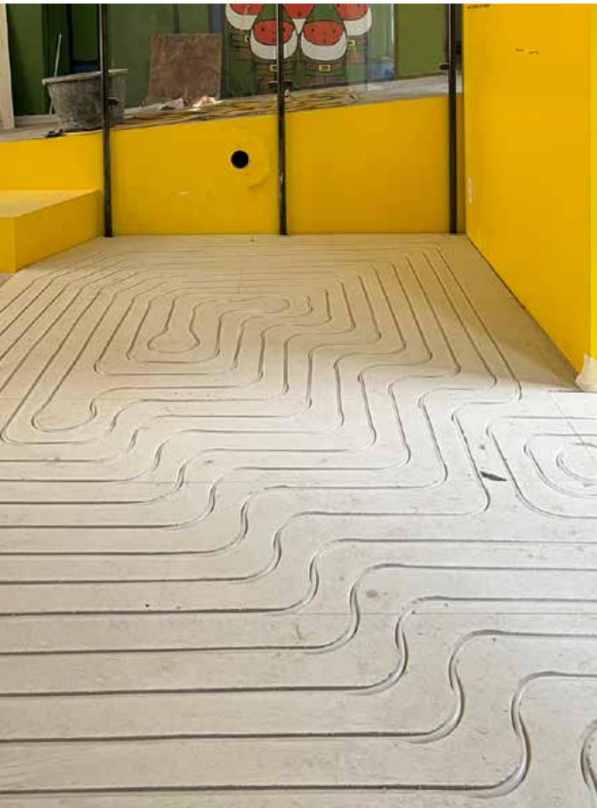
Doordat de vloerverwarmingsbuizen direct onder de vloerafwerking liggen, worden een snelle reactietijd en warmteafgifte geborgd.
